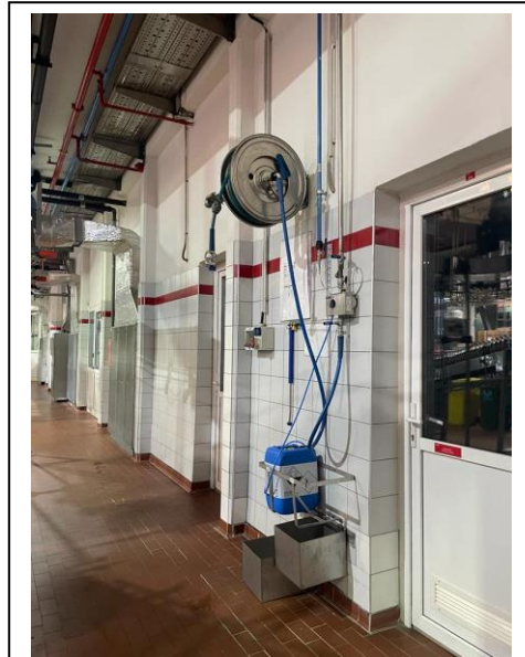
Schläuche wie dieser wurden genutzt, um Schaum auf die Luftförderschienen aufzutragen, wozu die Schläuche quer durch die Produktionshalle gespannt wurden
